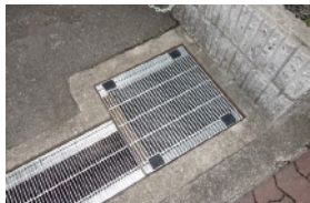
再めっきを施したグレーチング
